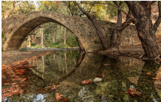
Εικόνα 4.9: Το ενετικό γεφύρι Τζιελεφού που ενώνει τις όχθες του ποταμού Διάριζου στην επαρχία Πάφου. (φωτογρ.: Μ. Ανδρέου)
