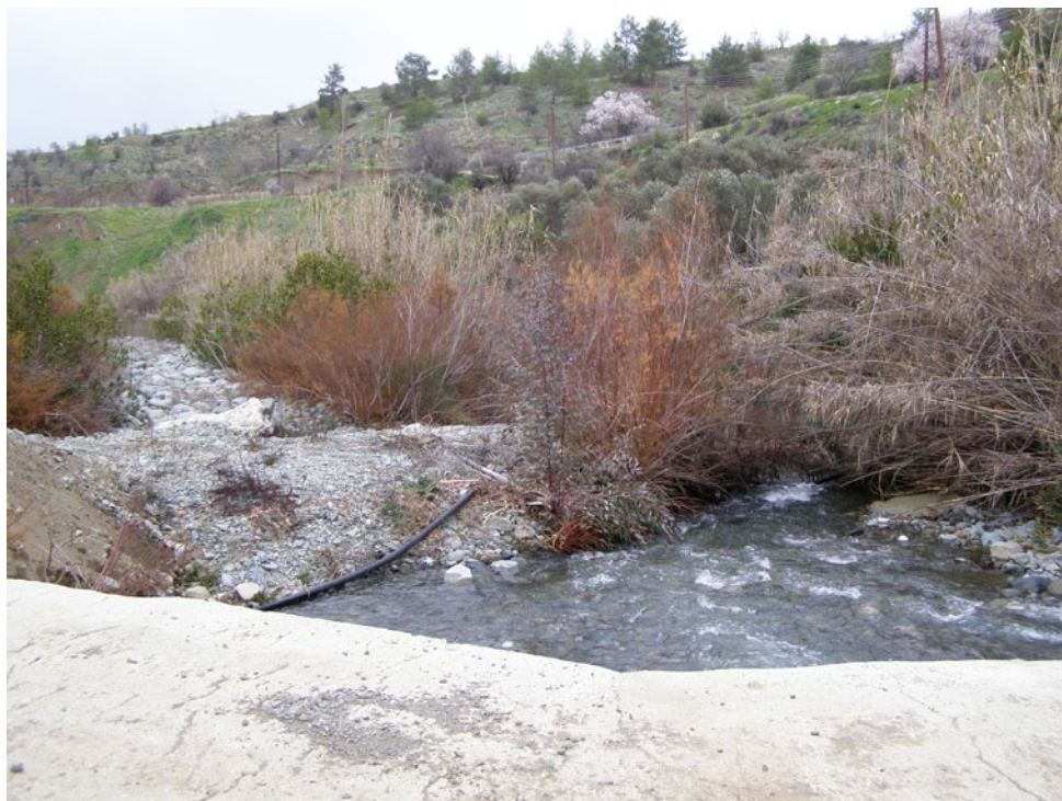
Εικόνα 8.7: Μετατόπιση κοίτης του ποταμού λόγω εσφαλμένου σχεδιασμού και χωροθέτησης γέφυρας (φωτογρ.: Ιάκωβος Τζιωρτζής)
